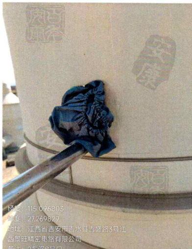
2-8#集尘房环境抽风、集尘房风机排风废气排放口
