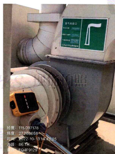
2-33#包装线热排风 FQ-4F9129 废气排放口
