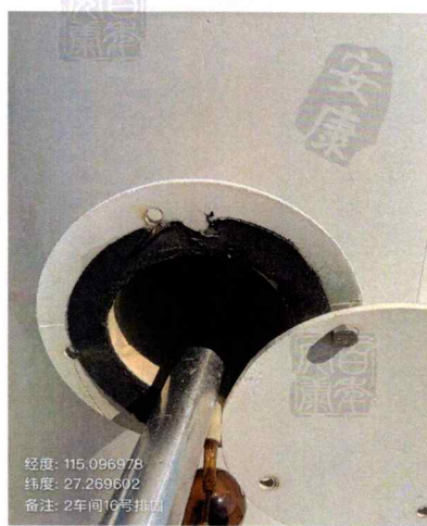
2-16#DVCP 线废气排放口
