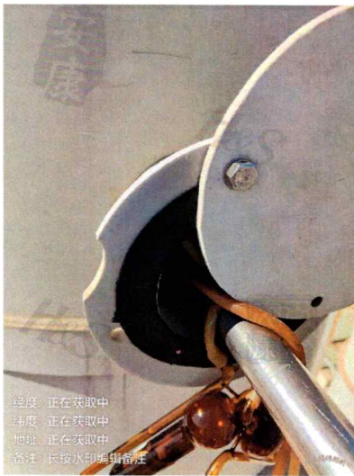
2-15#DVCP 线废气排放口
