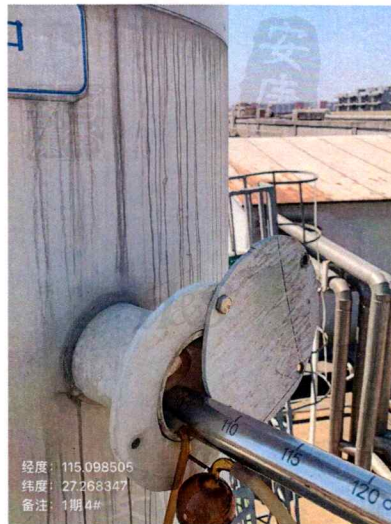
1-4#图电3线废气排放口
