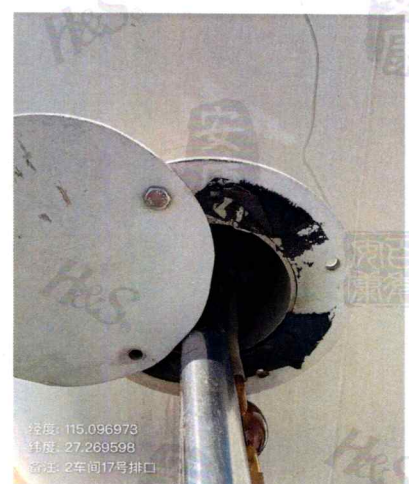
2-17#DVCP 线废气排放口
