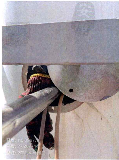
2-41#中央储药废气排放口
