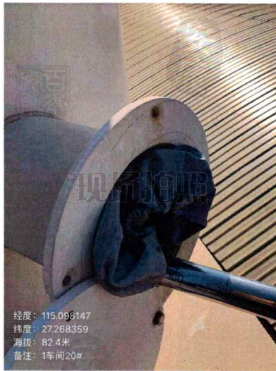
1-20#粉尘房废气排放口
