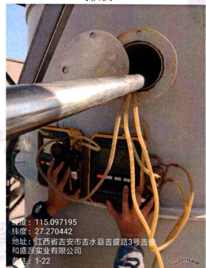
1-22#废液回收综合废气排放口
