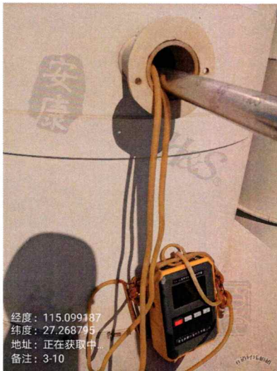
3-10#废水处理站源水池废气排 放口
