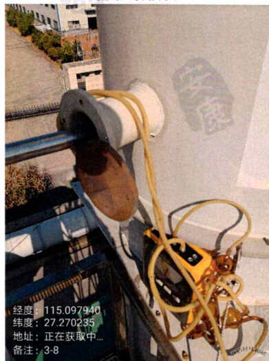
3-8#废水处理站废仓库、药剂暂 存区废气排放口
