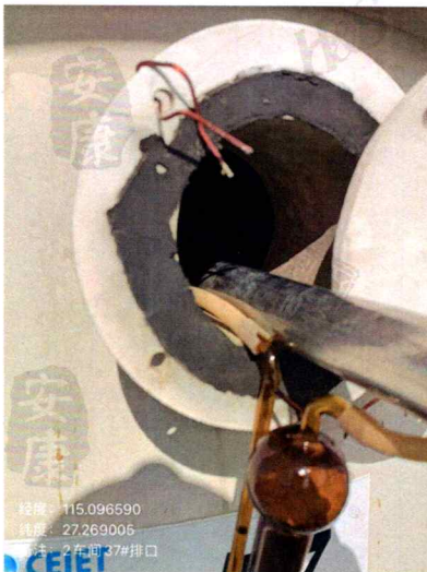
2-37#沉金线废气排放口
