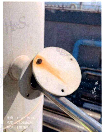
1-18#棕化线及压合压机废气排放口
