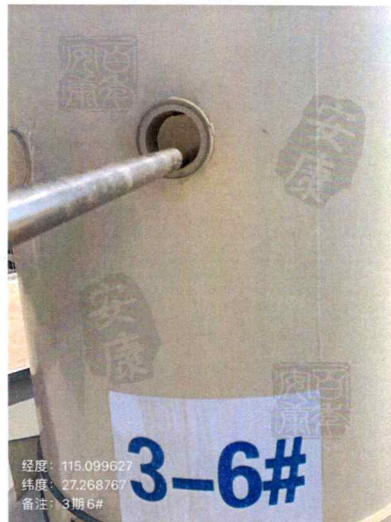
3-6#集尘房环境抽风、集尘房风 机排风废气排放口
