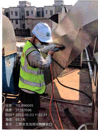
食堂二楼油烟废气排放口
