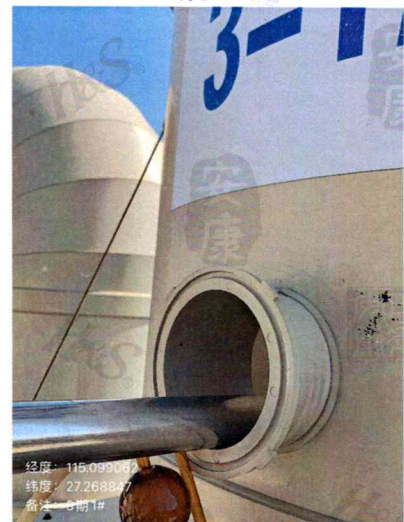
3-1#1 条 DVCP 线+1 条水平 PTH 线废气排放口
