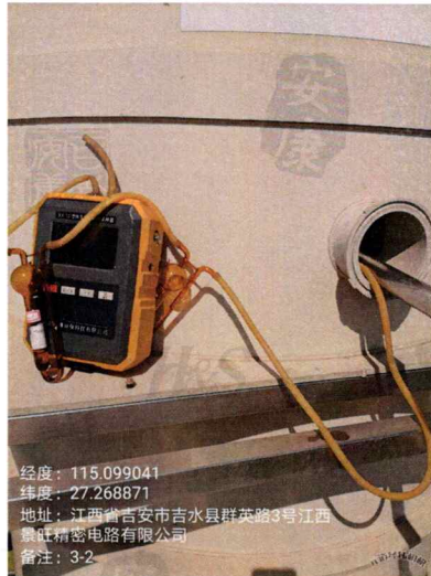
3-2#1 条 DVCP 线+1 条水平 PTH 线废气排放口
