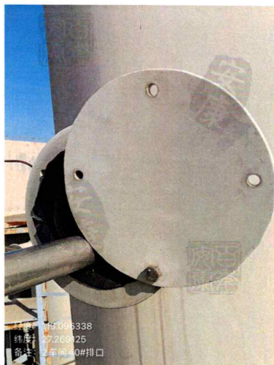
2-40#喷锡前后处理线废气排放口
