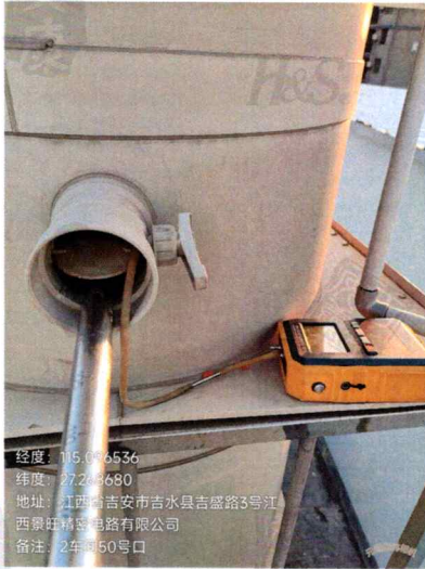
2-50#沉锡前处理UV机有机废气排放口
