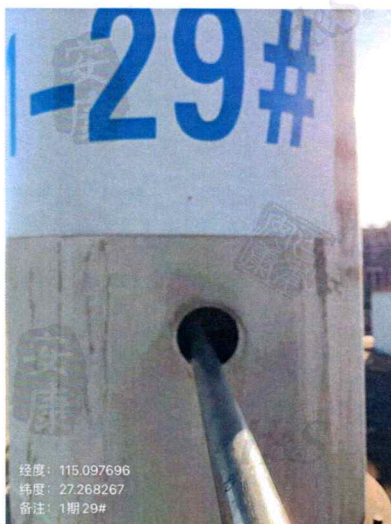
1-29#粉尘房废气排放口
