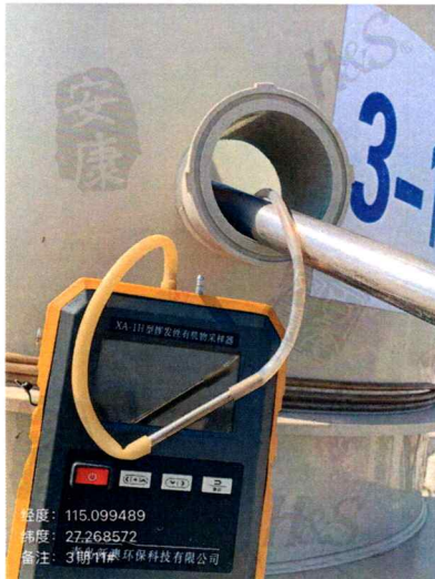
3-11#阻焊喷涂+预烤废气排放口
