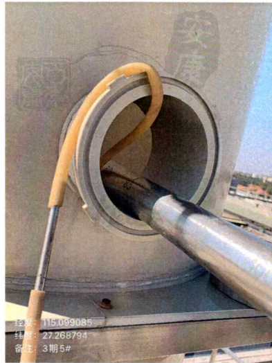
3-5#树脂塞孔废气排放口
