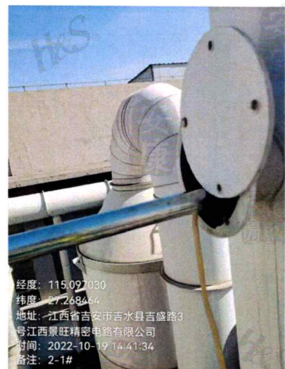
2-1#内层前处理、包装前清洗废气排放口
