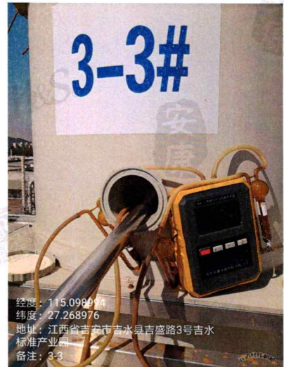
3-3#三四楼药桶及环境抽风废气 排放口
