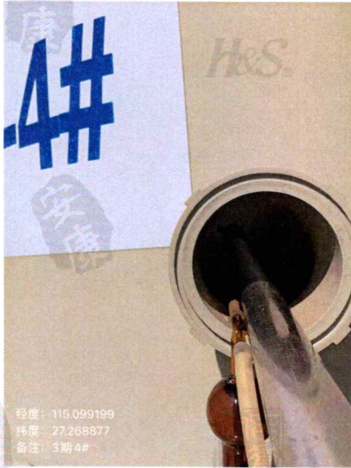
3-4#2 条水平 PTH 线+中央加药房碱性废气排放口
