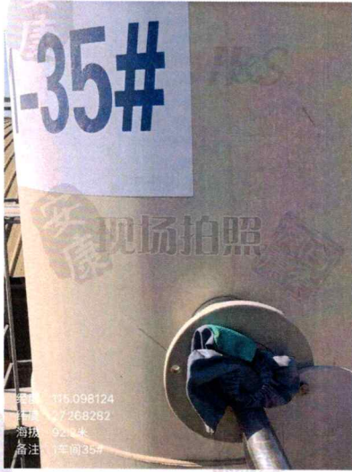
1-35#集尘机和备用风机的排风、集尘房环境抽风废气排放口
