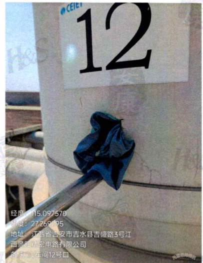
2-12#集尘房环境抽风、集尘房风机排风废气排放口
