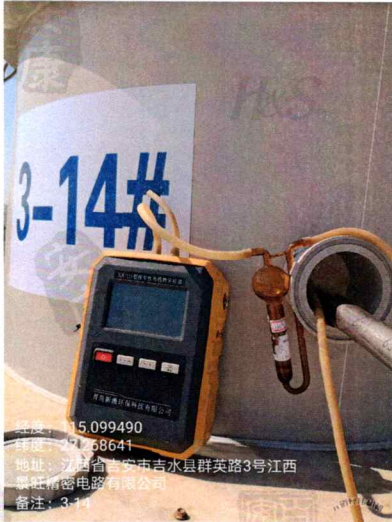
3-14#外层蚀刻废气排放口
