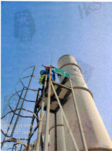
2-42#中央储药废气排放口
